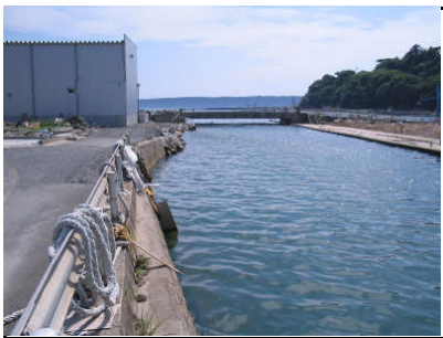
⑤護岸が沈下した鮎川地区
